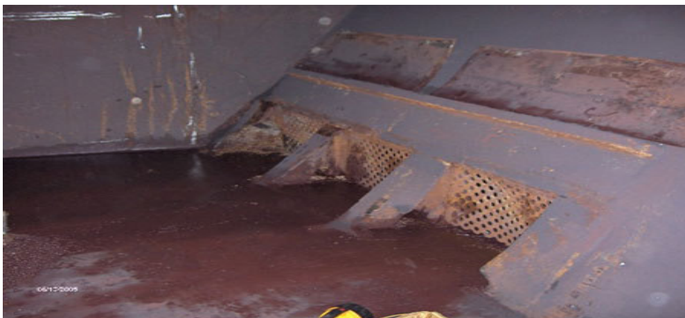
Figure I.1: Photos des cales d'un navire
