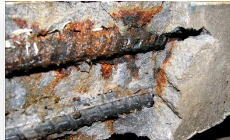
Fig. N°19 : Corrosion du béton armé
