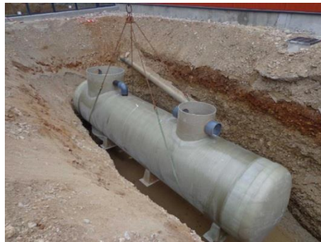
Fig. N° 31 : cuve de PVR
