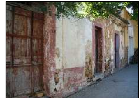
Figure 04: dégradation du bâti
