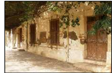
Figure 03: Maisons coloniales délabrées
