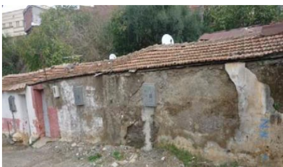
Figure 55: Bâti en mauvais état, photos prise par hauteur
