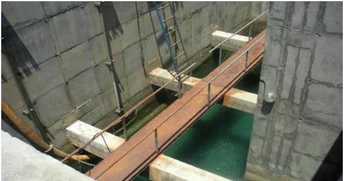
Photo 11 : Puits de récolte d'eau
