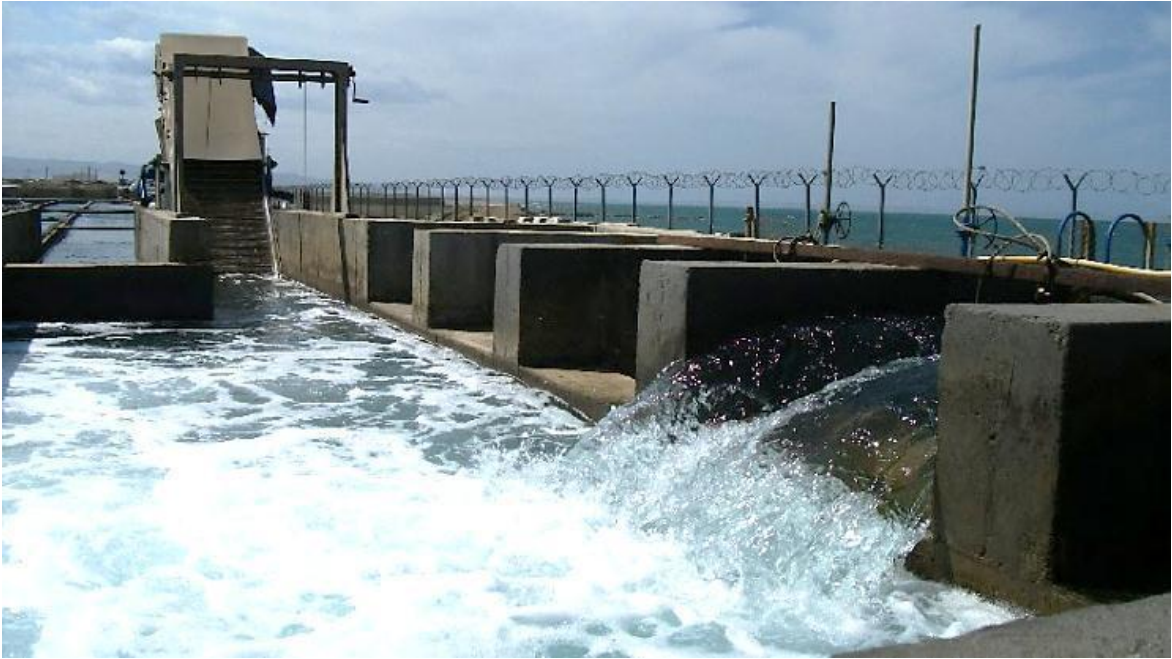
Photo 12 : Remontée d'eau grâce à l'une des pompes installées.
