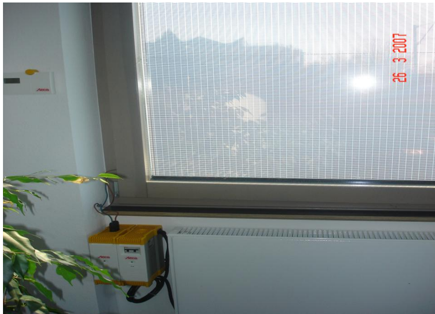
Figure 2.2 : Fenêtre-module photovoltaïque et onduleur d'un petit système PV connecté au réseau, bâtiment de Fraunhofer Gesellschaft (Allemagne)
