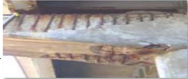
Figure41 :L'humidité cause de graves dommages sur la structure d'une construction . Elle a des effets néfastes sur la chimie des structures physiques des parois.
