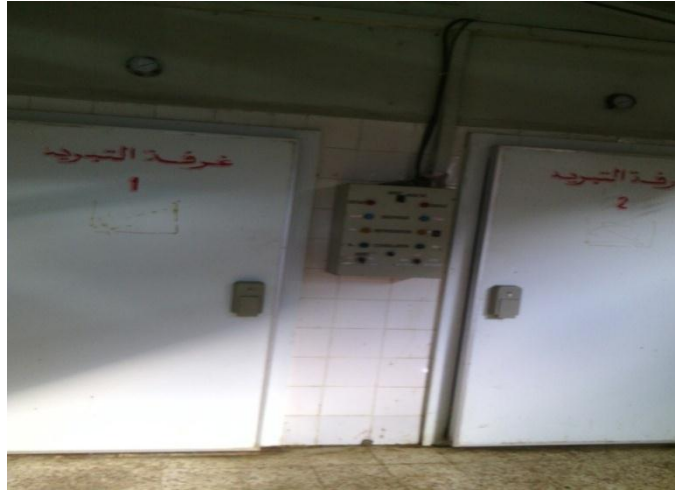
Figure 14: Les chambres froides (photo personnel, 2015).
