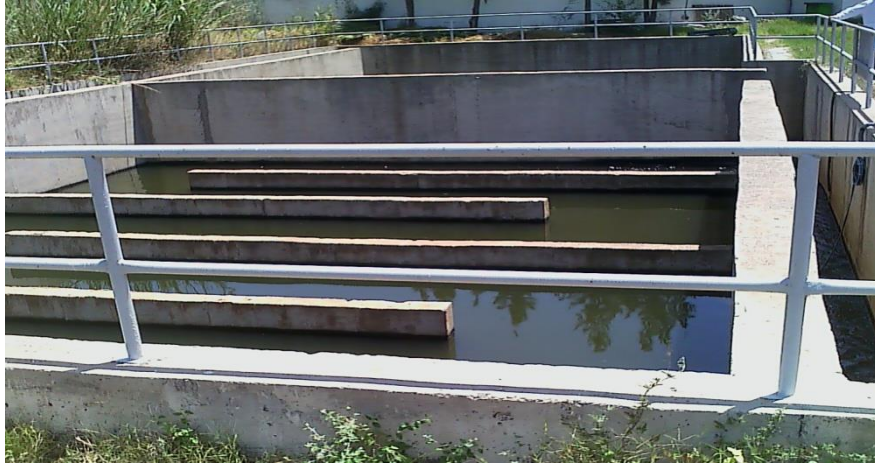
Figure 35 : Bassin de chloration
