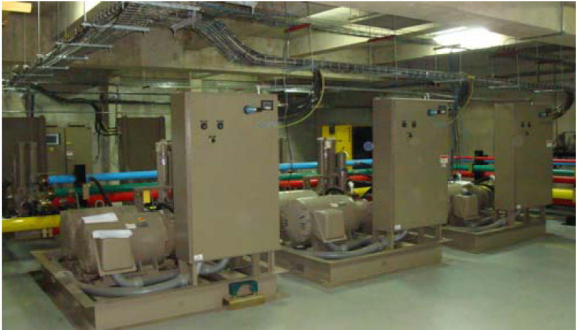
Figure 2.10 : Vue de la centrale hydraulique
