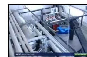
Figure 47 Utilisation de deux chaudières à bois
