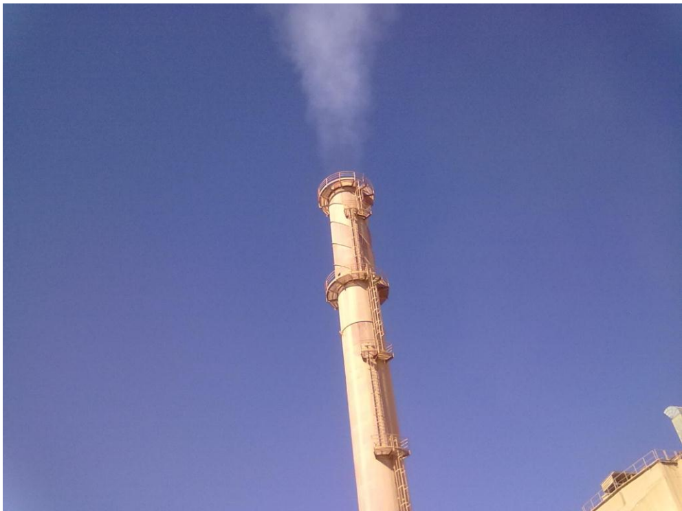
Figure 4.7 : Sortie des gaz fumés après passage dans l'électrofiltre (cimenterie de Meftah)
