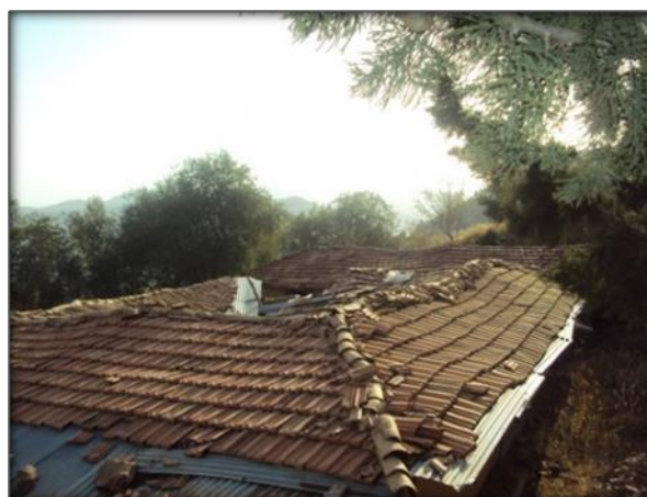
Photo 4 Maison en terre avec Changement de tuile source : auteur 2017
