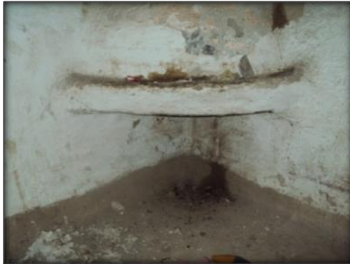
Photo 12 : le four de la maison source : auteur 2017
