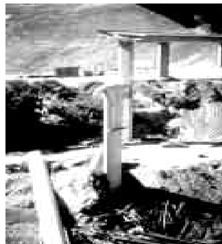
Figure 2.3: Echappement dû à une courbure importante (San Fernando,1971) [22].
