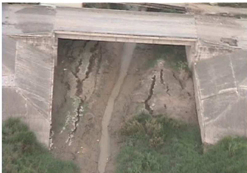
Figure 2.8 : Liquéfaction du sol.
