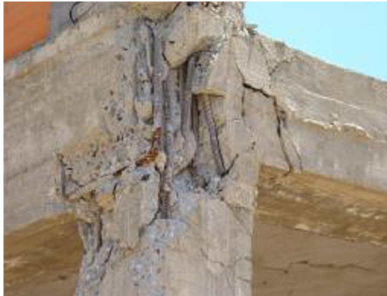
Figure 1.4: formation de rotule en tête de poteau [47].
