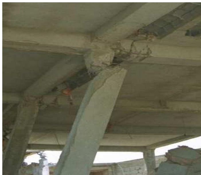
Figure 1.5: éclatement des armatures transversales [47].
