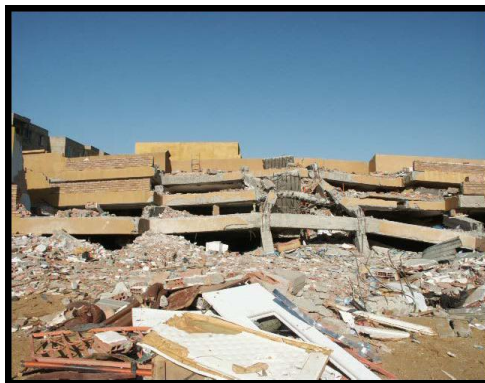
Figure 2.35: Effondrement totale de la structure (pancake Rupture « fragile » de poteau et poutres de béton armé de mauvaise qualité ( Séisme de Boumerdes, 2003 )
