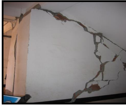
Figure 2.26 : Désordre de la maçonnerie sous la paillasse d'escaliers. (Séisme de Boumerdes 2003)
