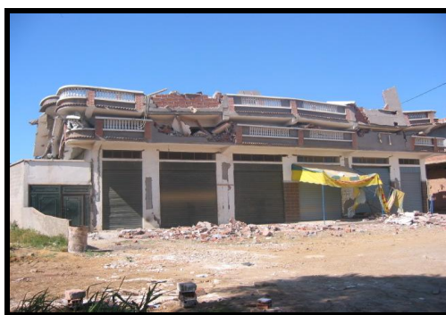
Figure 2.40 : Disparition du 1 er étage. Cette photo illustre le cas de niveau flexible par rapport au RDC qui s'est trouvé plus rigide par la présence des rideaux en fer fermé. ( Séisme de Boumerdes, 2003 )
