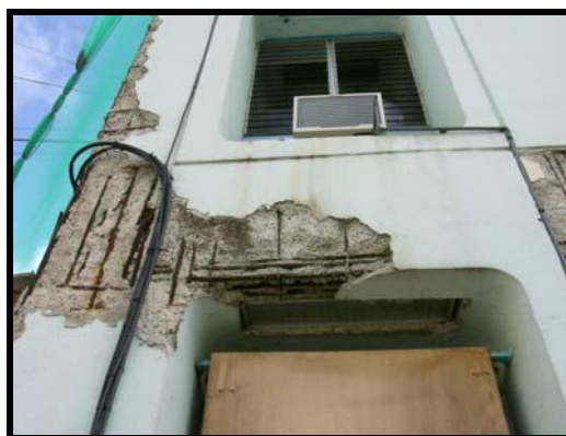
Figure 2.37: Corrosion d'aciers dont l'enrobage ne respecte pas les dispositions réglementaires du BAEL en atmosphère ( Séisme de Boumerdes, 2003 )
