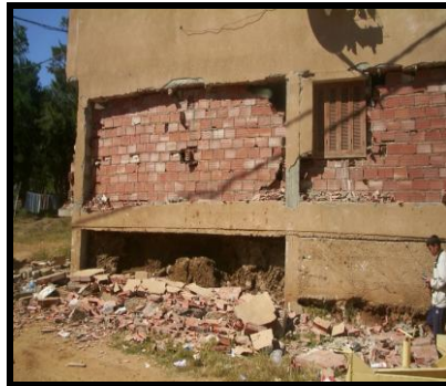
Figure 2.23 : La section des poteaux étant souvent équivalente à celle des poutres, la plastification des nœuds se produit en tête ou en pied de poteau (Séisme de Boumerdes 2003)
