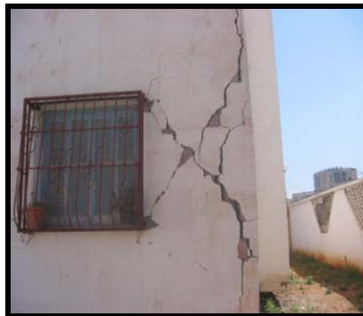
Figure 2.24 : Fissuration du trumeau extérieur de la maçonnerie (paroi extérieure non raidie). (Séisme de Boumerdes 2003)
