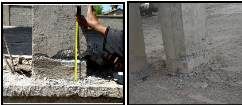
Figure 2.36 : Talonnette (Appelle aussi Dé de calage ) le de 10cm en Béton de très mauvaise qualité ( Séisme de Boumerdes, 2003 )
