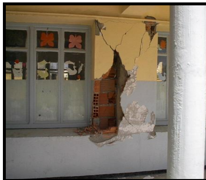
Figure 2.25 : Dommage conséquent de cette maçonnerie en saillie par manque de raidisseurs aux angles. (Séisme de Boumerdes 2003)
