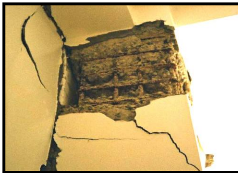
Figure 2.34: Béton non vibré Mauvaise exécution, ségrégation du béton au niveau de la zone nodal ( Séisme de Boumerdes, 2003 )
