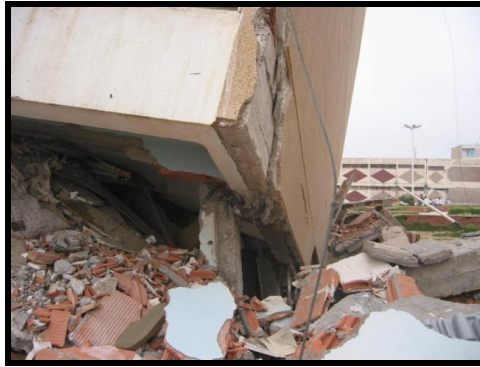
Figure 2.41 : Perte de niveau : Noter la perte d'appui sur le poteau au premier plan. Ce poteau est dirigé selon sa petite inertie dans le sens transversal du bâtiment. (Séisme de Boumerdes, 2003)
