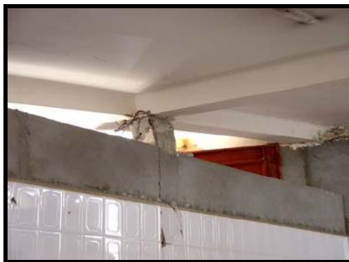
Figure 2.38 : Détail de destruction des poteaux à cause de fonctionnement en «poteau courte» ( Séisme de Boumerdes, 2003 )
