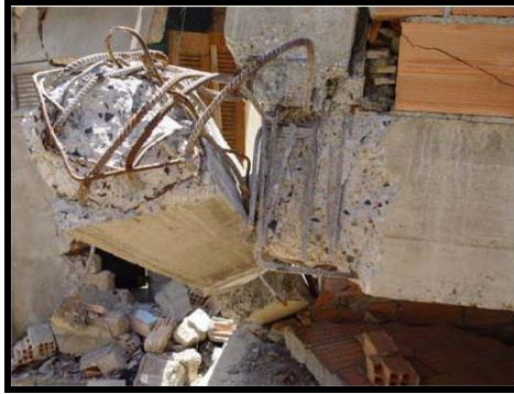
Figure 2.32 : Effondrement à cause de l'absence d'armatures transversales dans les nœuds et dans la zone critique du poteau ( Séisme de Boumerdes 2003 )
