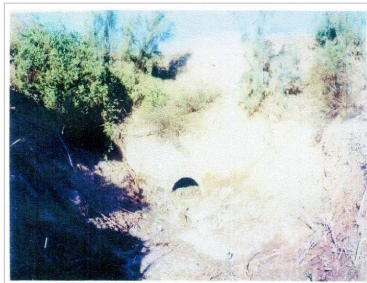
Figure.3.18 : Photo d'un drain colmaté
