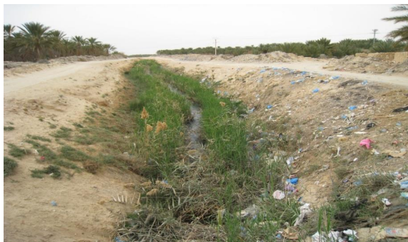
Figure.3.19 : Fossés de drainage dégradés suite au manque d'entretien [23]
