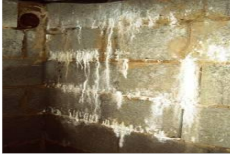
Figure.3.30 : Détérioration de l'habitation due à la remontée des eaux
