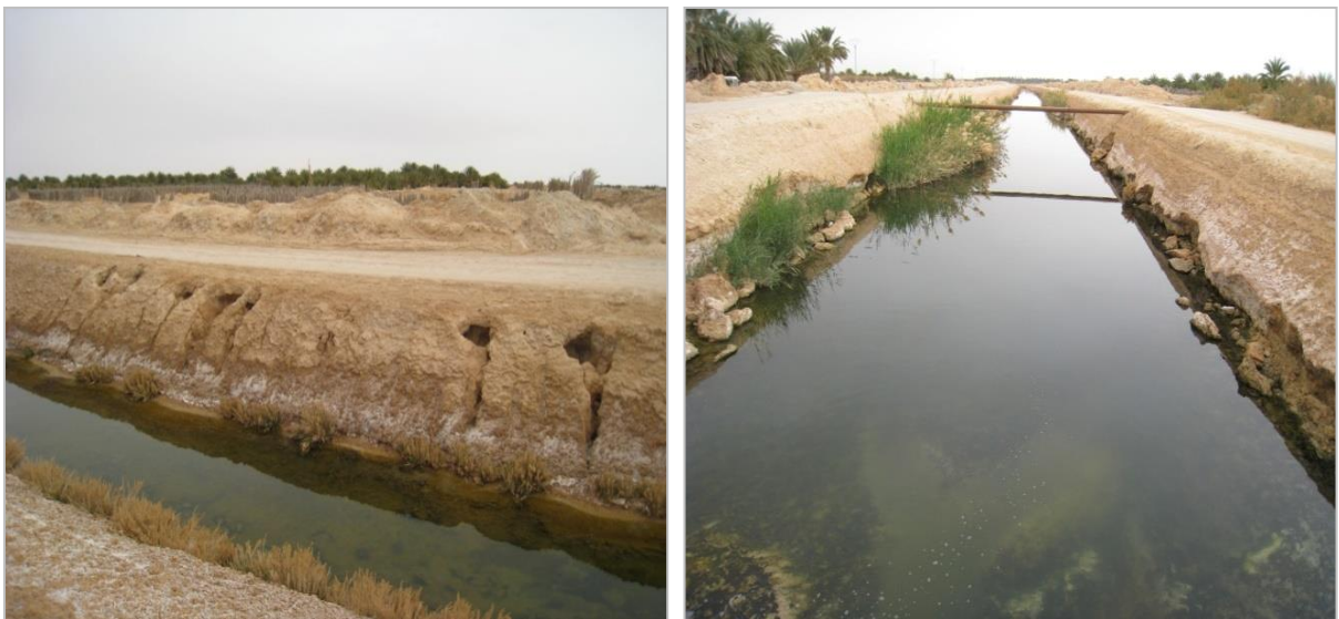
Figure.5.6 : Eboulement et affouillement des talus le long du canal [23]
