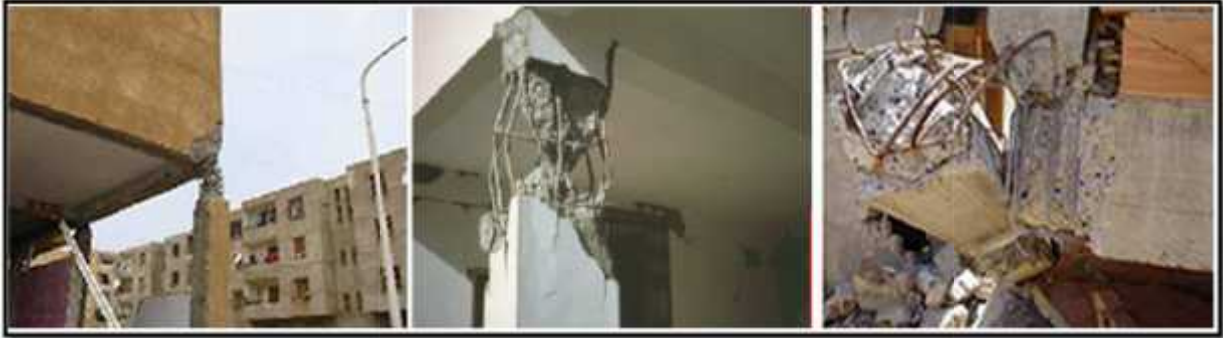
Figure II. 90 : les catastrophes des séismes. (Source :site web : béton-blindé).
