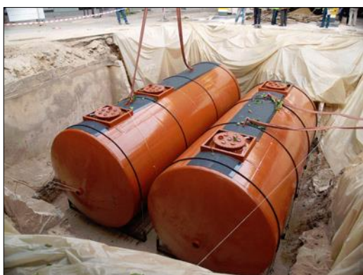
Figure 15 : cuve de stockage en Acier galvanisé Source: alce-cde.com
