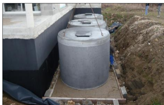
Figure 13 : cuve de stockage en béton Source:beau.debmixture.com
