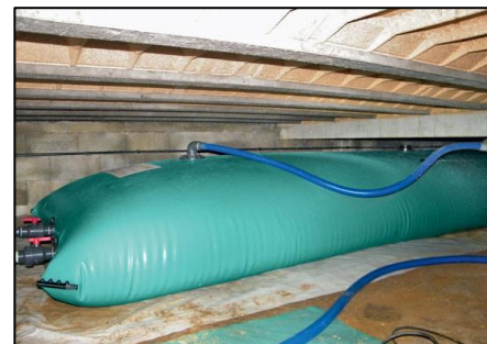
Figure 103 : cuve de stockage installée au sous-sol. Source : maison-travaux.fr
