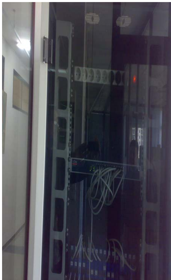
Armoire de brassage des postes de travail reliés au serveur via le réseau informatique.
