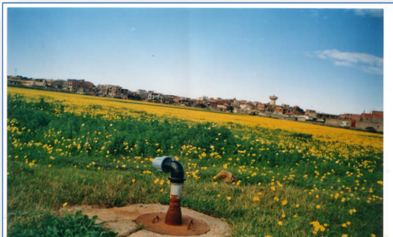
Bordj El Kiffane, EAC IV : Un forage complètement affecté par le phénomène de l'invasion des eaux de mer, bouchonné pour éviter son exploitation
