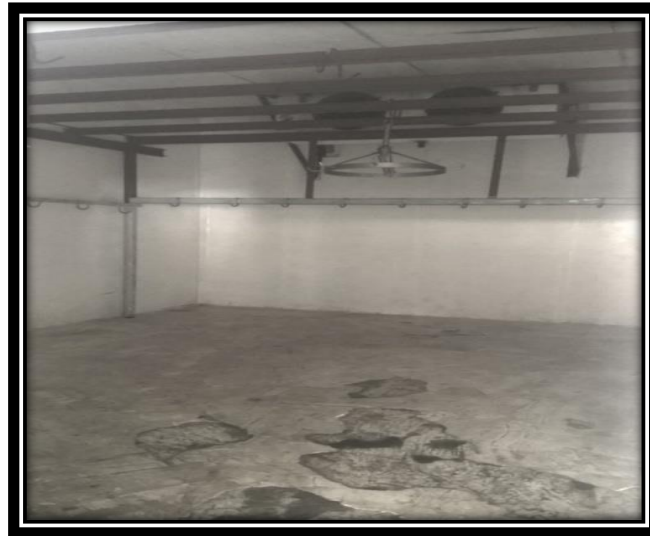
Figure 6 : Chambre frigorifique de l'abattoir d'IGHIL ALI (Photo personnelle, 2019).
