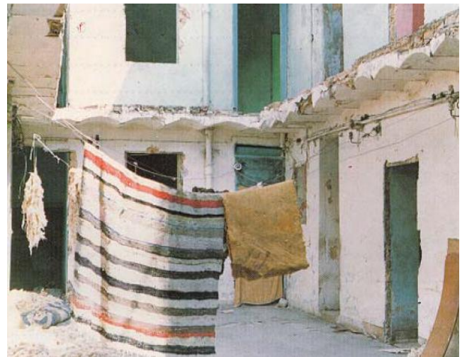
fig4 : Etat de dégradation d'une maison
