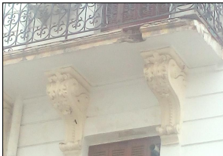
Fig. II.19. Élément décoratif non porteur immeuble à la Rue Abane Ramdane Constantine source : Auteur
