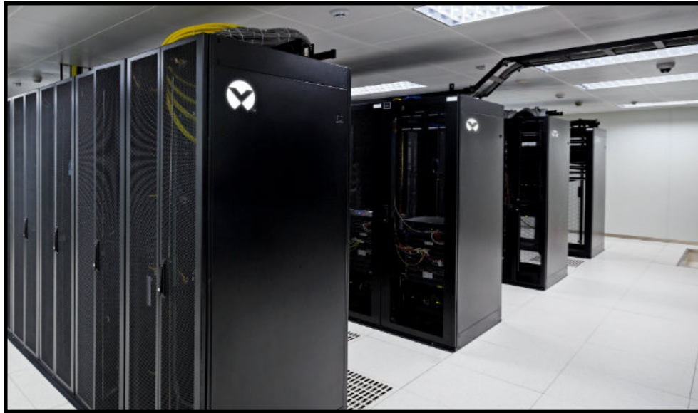
Figure 4: Une salle de serveurs dans un data center. [16]
