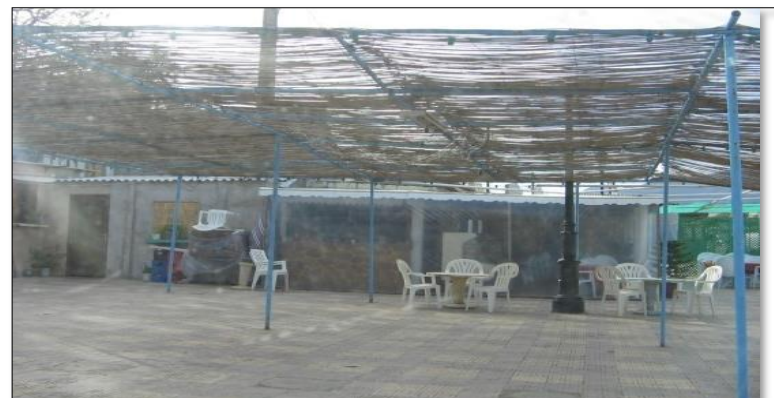
Image 04: Absence d'équipements d'aménagement
