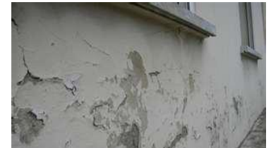
Figure 1: humidité sur la façade Source: www.humidité de façade.com
