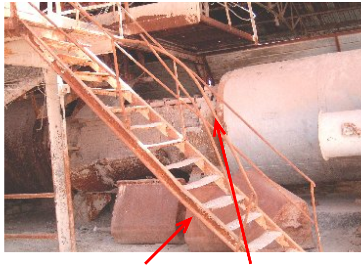
Figure 3.32: Escalier et garde corps en piteux état.
