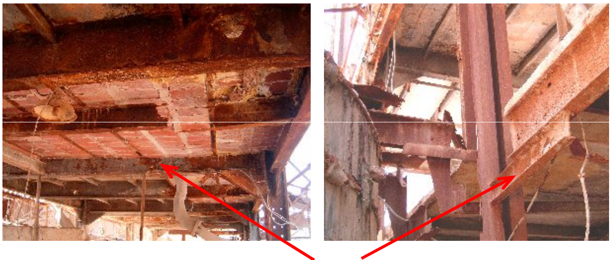
Figure 3.30: Effondrement de la dalle de plancher et réparations archaïques.
