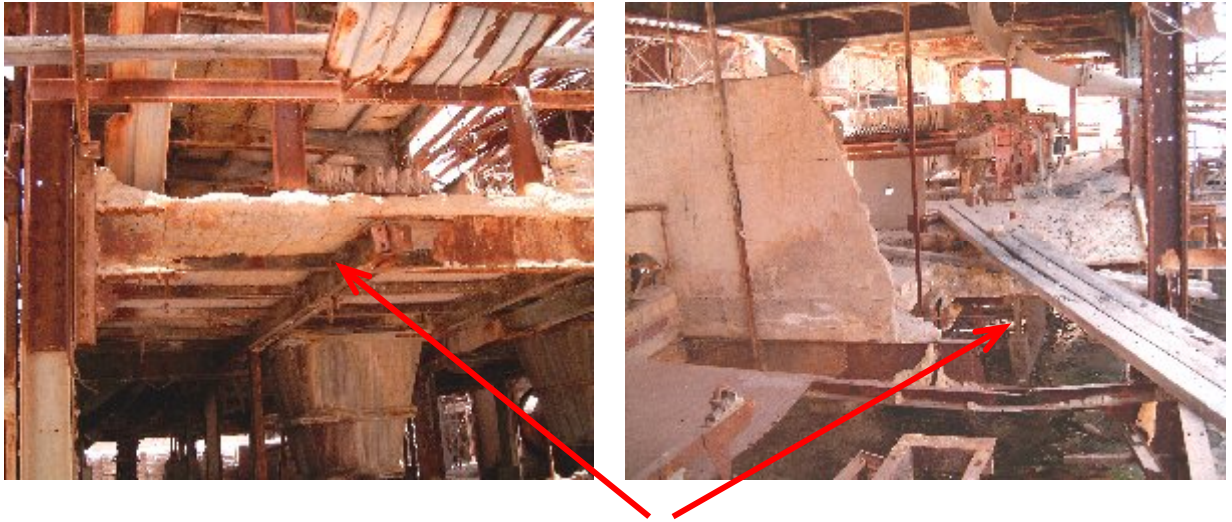
Figure 3.28: Altération profonde des poutres et des planchers.
