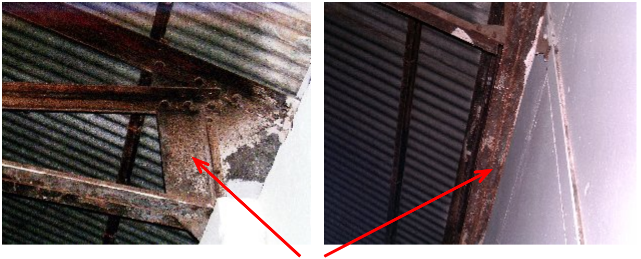
Figure 3.18 : Corrosion avancée des éléments porteurs.
