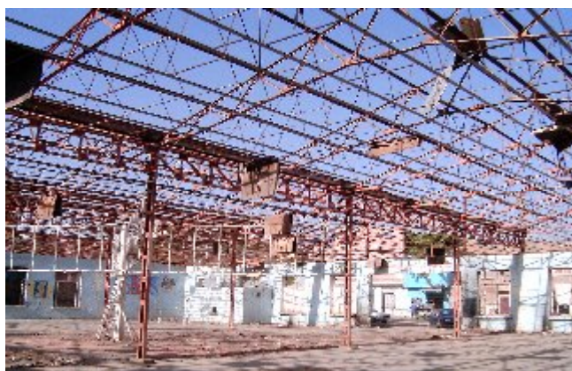
Figure 3.42 : Marché : vu de l'intérieur, absence totale du bardage.
