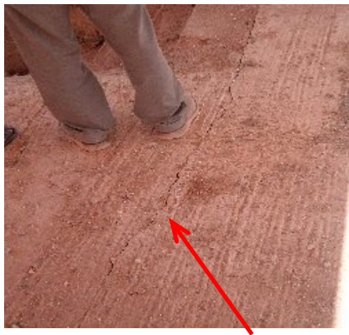
Figure 3.40 : Fissure dans les dallages.
