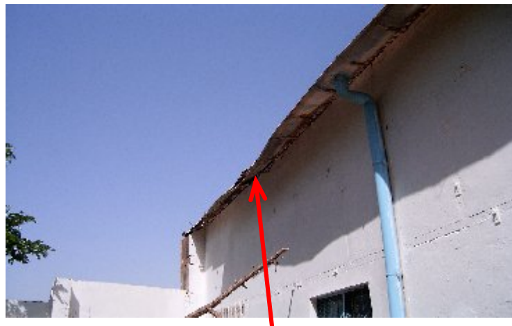
Figure 3.22 : Dégradation des descentes d'eaux pluviales.
