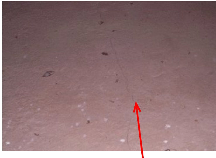
Figure 3.21 : Présence de fissurations dans les dallages.
