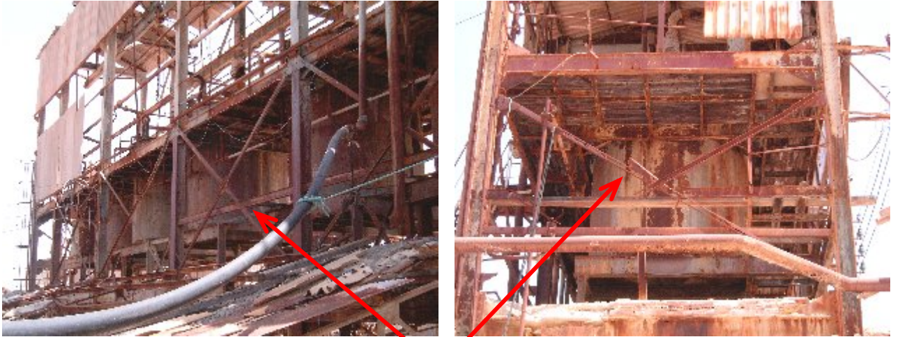
Figure 3.25 : dégradations subies : système de contreventement.
