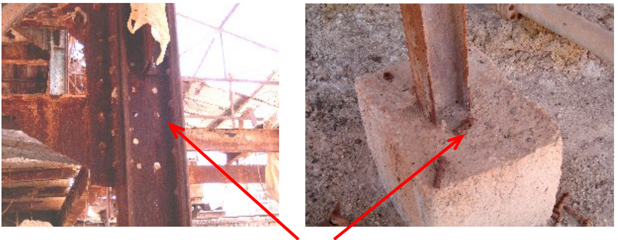
Figure 3.27 : Manque de boulons et endommagement des assemblages.
