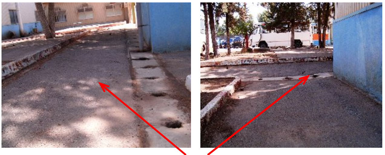
Figure 3.12 : Affaissement du terrain.
