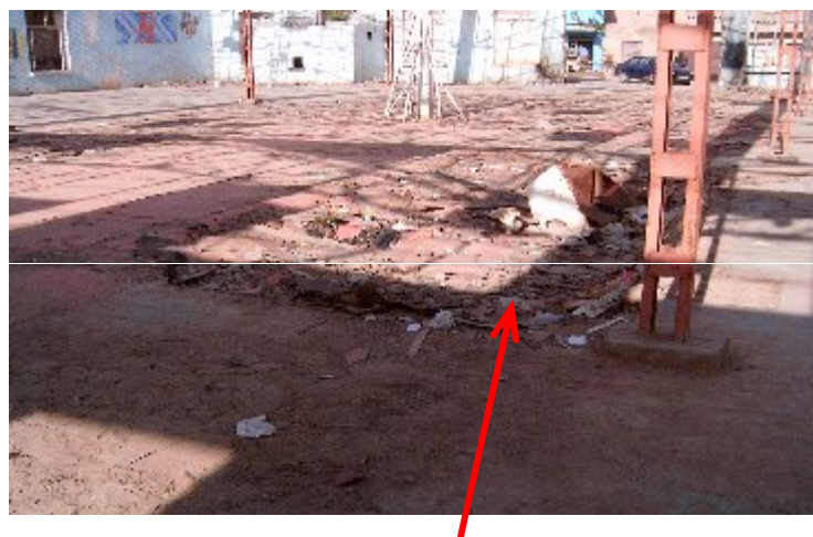
Figure 3.45 : Affaissement du dallage.
