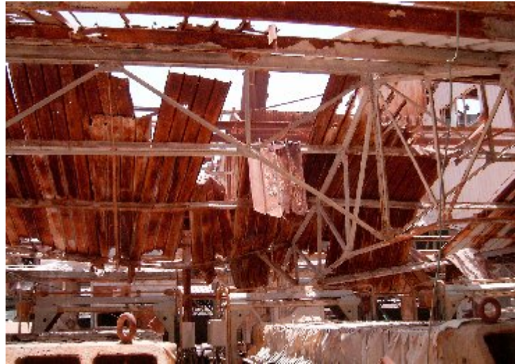
Figure 3.31: Très mauvais état du bardage et de la toiture.
