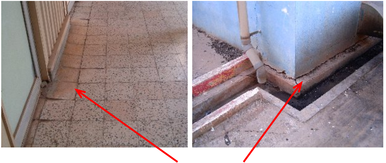
Figure 3.11 : Ouverture des joints de revêtements et fissures à la base des murs.
