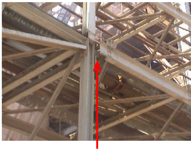
Figure 3.59 : Détachement de la poutre de son appui.
