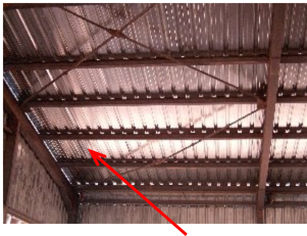
Figure 3.39: Manque d'une diagonale dans la toiture.
