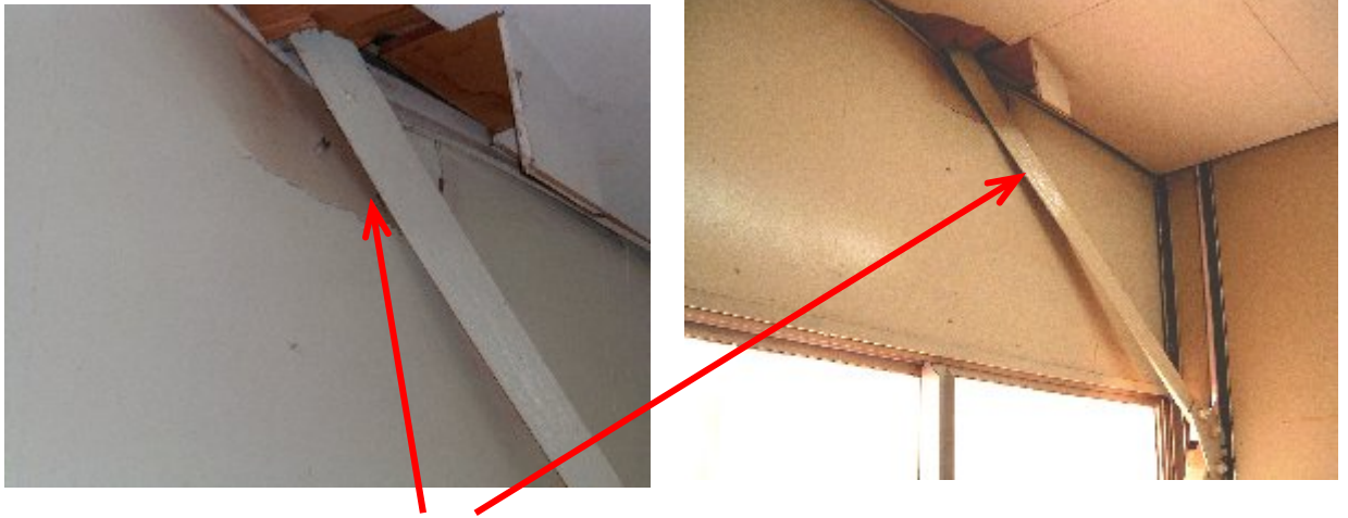
Figure 3.10 : Autres phénomènes d'instabilité sur les barres des contreventements.
