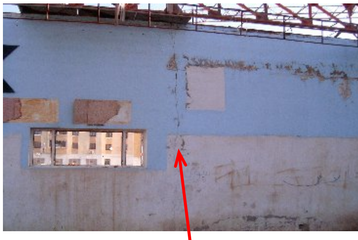
Figure 3.46 : Présence de fissuration dans les murs.
