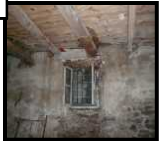
Structure et matériaux endommagée
