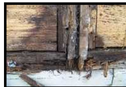
Pourrissement du bois dû aux exfiltrations d'air dans une maison
