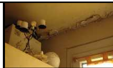
Écaillage de la peinture au niveau du pont thermique entre le muret le plafond.
