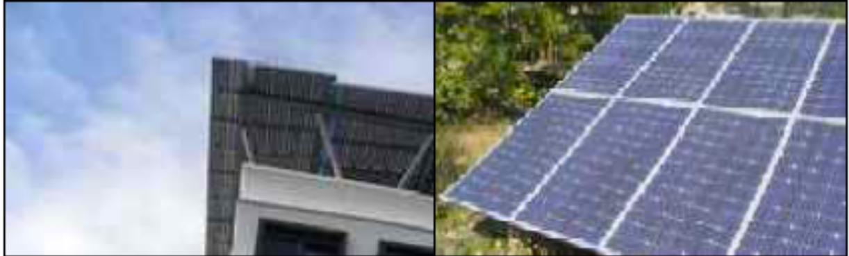
figure 64 : images de panneaux photovoltaïque source :( Google image).
