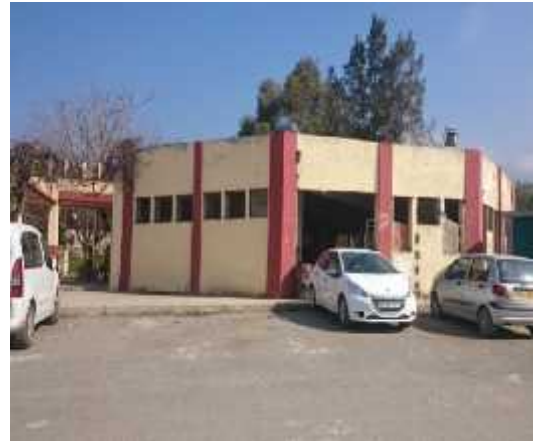
Figure3.53 : bâti en mauvaise état (source: auteur)
