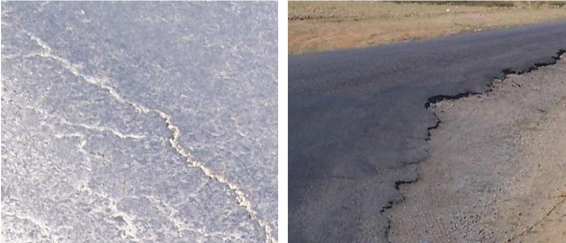
Figure 1.3 : Faïençage à mailles larges [1]. Figure 1.4 : État avancé du faïençage [1].
