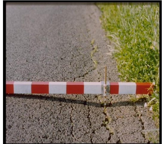
Figure 1.24 : Affaissements de rives [11].
