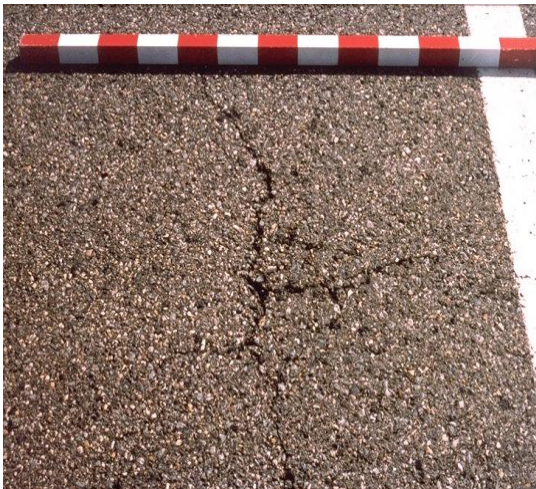
Figure 1.31 : Fissuration en étoile [11].
