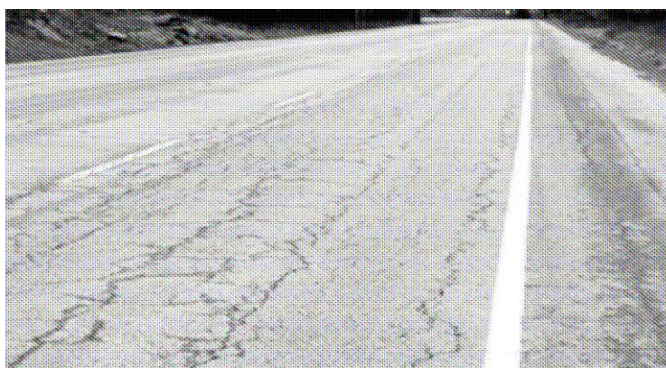
Figure A.3 : Fissuration par fatigue.
