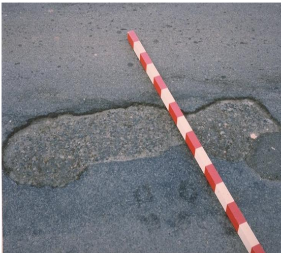
Figure 1.37 : Pelade de l'enrobé (niveau 3) [11].
