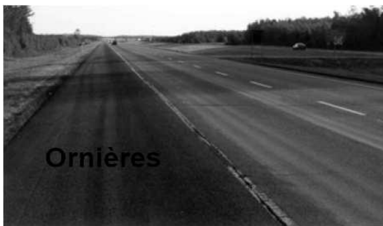
Figure A.2 : Orniérage des chaussées.
