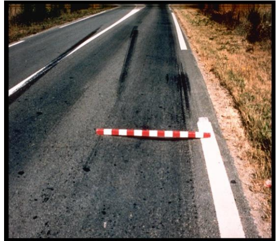
Figure 1.22 : Orniéage à grand rayon dans la Chaussée routière [11].
