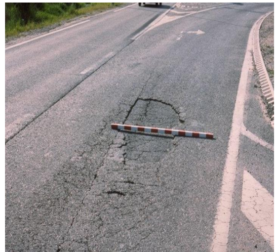
Figure 1.38 : Pelade de l'enrobé (niveau 2) [11].
