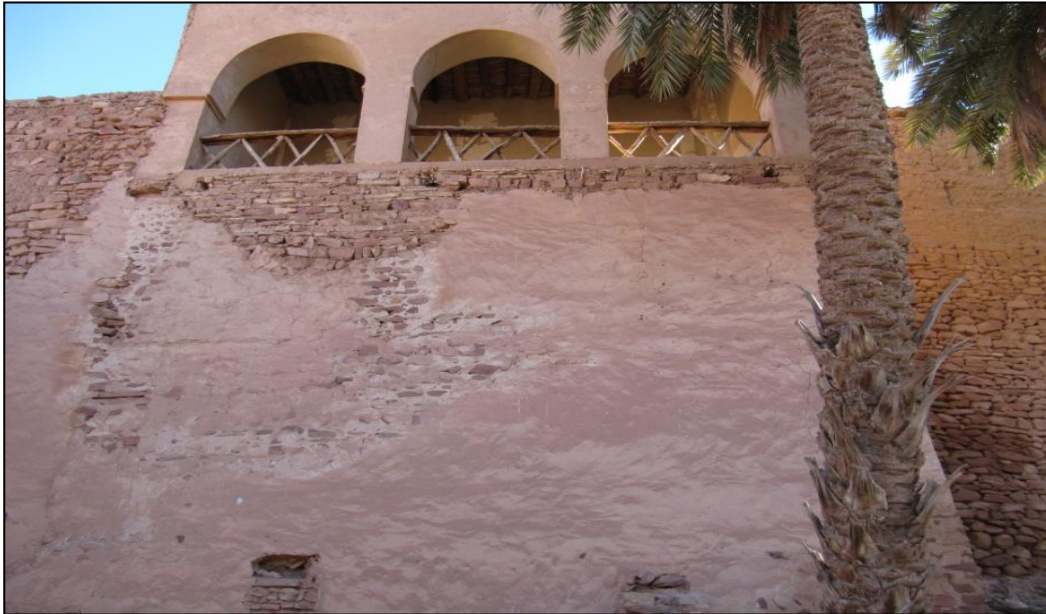
Fig115 : Dégradation du mur porteur de Dar El Baida,source : Image prise par l'auteur 10/2017.
