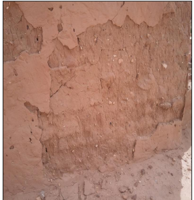
Fig112 : Effritement du mortier des murs extérieur de la zaouïa, source : Image prise par l'auteur 10/2017.
