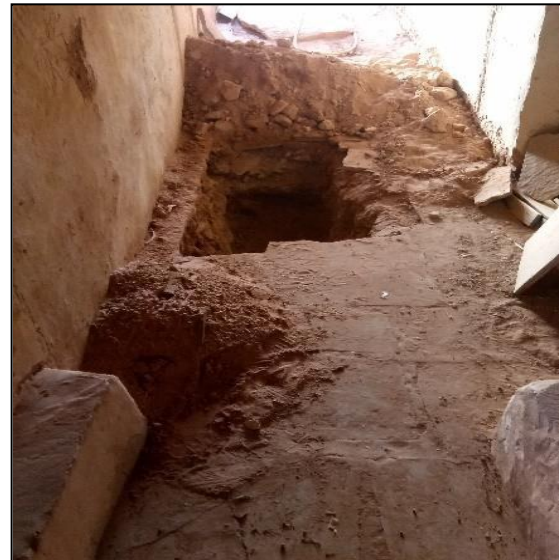
Fig131 : Réalisation de sondage au niveau du balcon de la zaouïa, source : Image prise par l'auteur02/ 2019.
