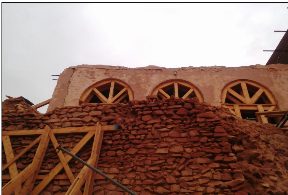
Fig119 : étaieement des arcades ainsi que la partie extérieure de la khalwa de la zaouïa, source : Image prise par l'auteur 02/2019.
