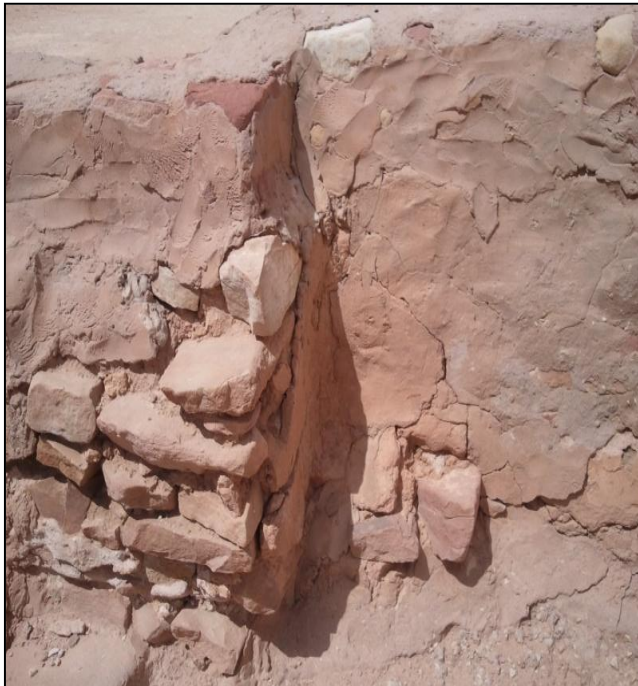
Fig111 : Décollement des pierres du toit de la zaouïa, source : Image prise par l'auteur10/ 2017.
