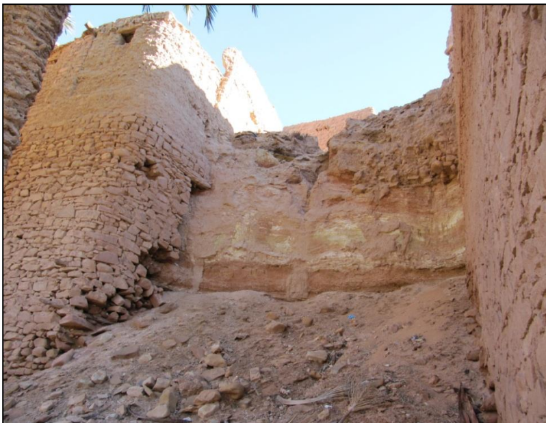
Fig116 : Effondrement du parement de terre dans l'espace qui juxtapose la Dar El Baida, source : Image prise par l'auteur 10/2017.
