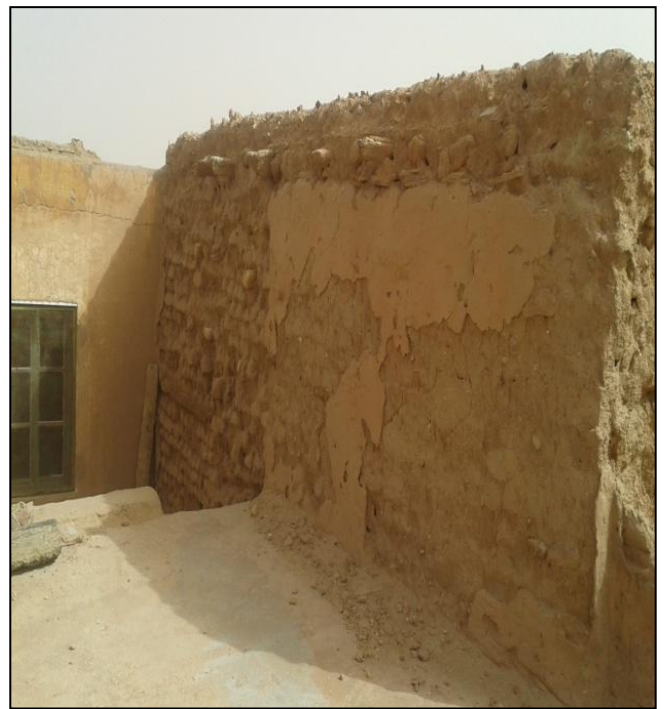
Fig114 : Effritement du mortier du mur de Dar El Baida, source : Image prise par l'auteur 10/2017.
