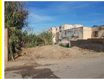
Figure III.22 Photo de travaux inachevés. Source : auteurs
