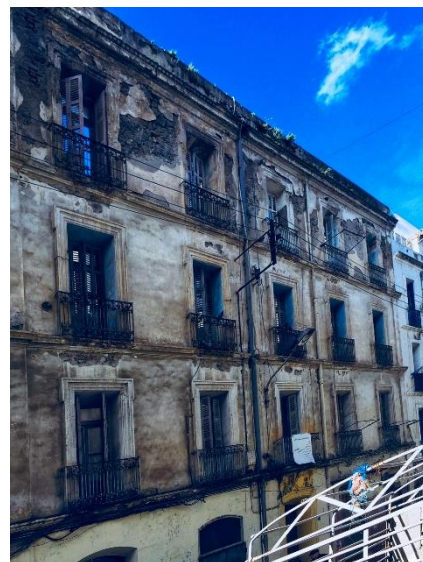
Figure IV-1 Façade en état de dégradation, source auteur
