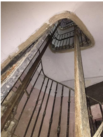
Figure IV-2 Cage d'escalier en état de dégradation, source auteur
