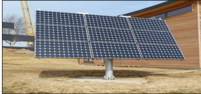
Figure 2.4 : Exemple d'une Installation munie d'un tracker [16].
