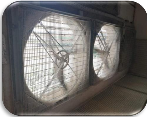
Figure 17 : Les ventilateurs Source : nous meme.2020
