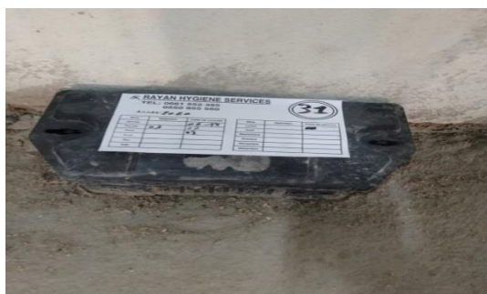
Figure 9 : Barrière à rongeurs
