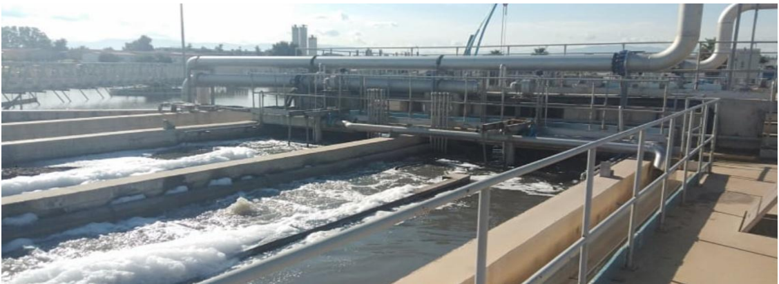
Figure 6 : Bassin dessablage/ déshuilage (photo originale)
