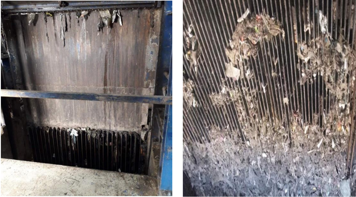
Figure 5 : Dégrilleur (photo originale)
