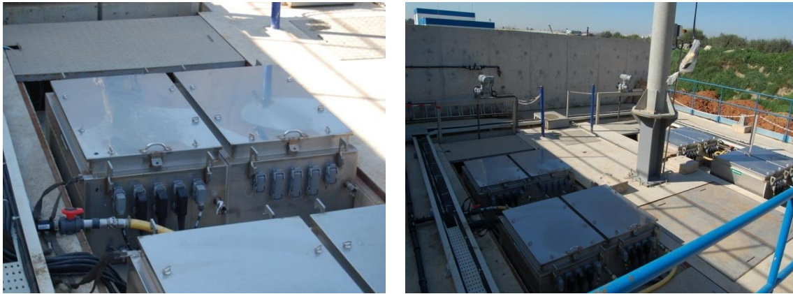
Figure 11: Les modules de désinfection UV (SEAAL, 2018).
