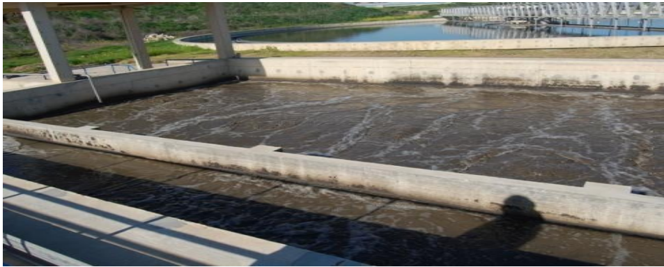
Figure 8: Ouvrage de dégazage (SEAAL, 2018).
