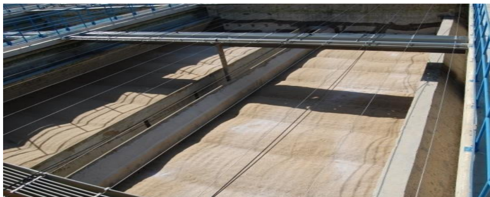
Figure 10: Ouvrage de filtration à sable, (aquazur v) (SEAAL, 2018).
