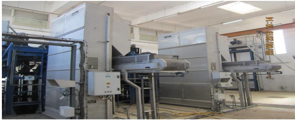
Figure 4: Vue d'ensemble de dégrilleur grossier et dégrilleur fin (SEAAL, 2018)
