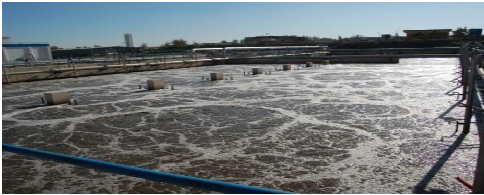
Figure 7: Bassins d'aération et boues activées (SEAAL, 2018).
