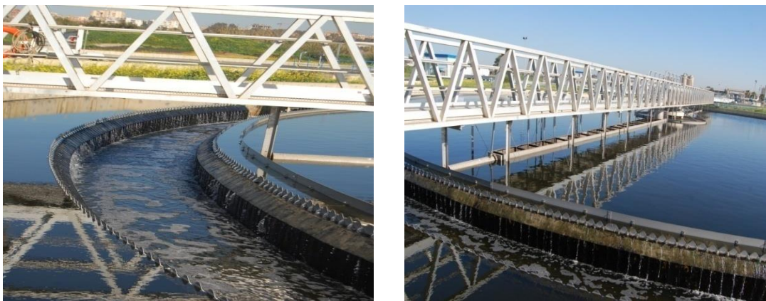
Figure 9 : Ouvrage de bassin de décantation secondaire (SEAAL, 2018).
