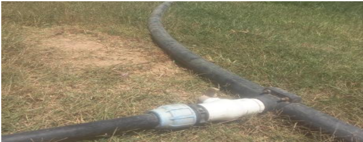
Figure 2. canalisation des asperseurs (route de Beni Tamou OEA le 15/05/2017)
