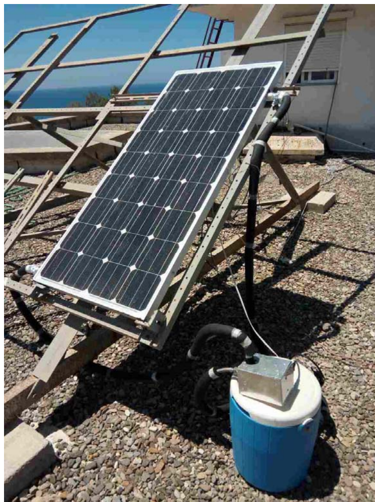
Figure III.23: PV/THERM installé sur le support en terrasse de l'UDES
