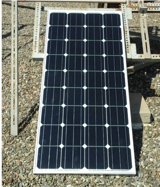
Figure III.20: le panneau photovoltaïque sur la terrasse de l'UDES
