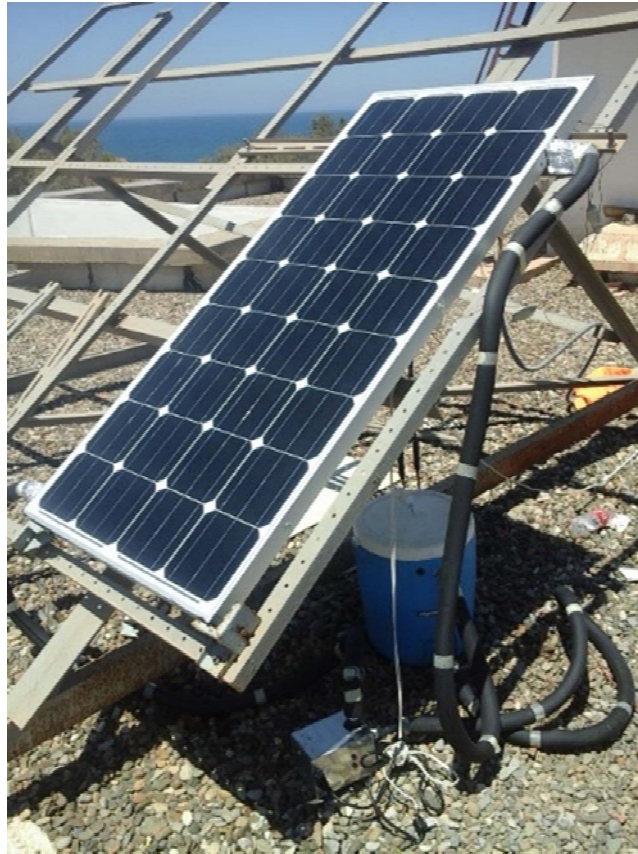
Figure III.2: capteur PV/THERM avec la cuve de stockage et la pompe
