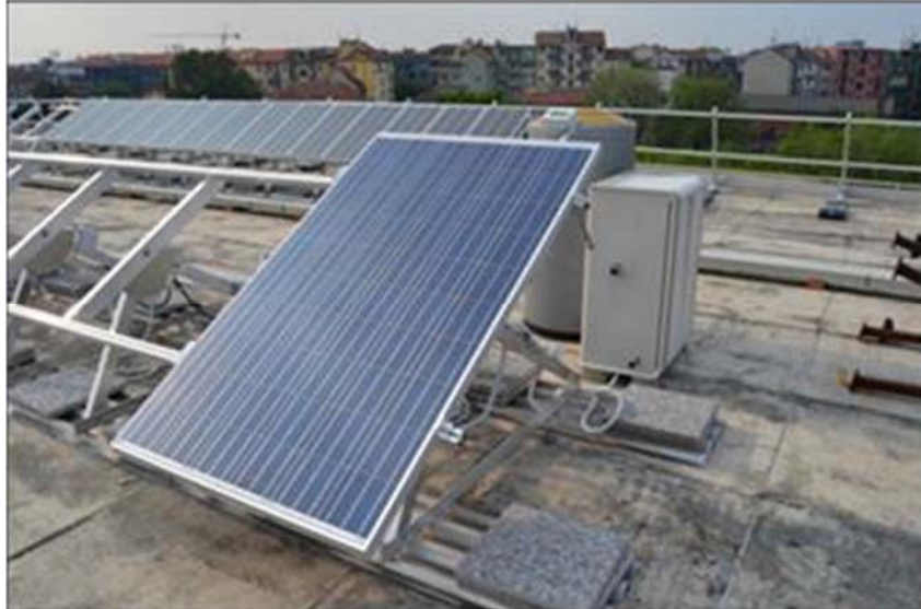
Figure I.7: test du PV/THERM sur le toit de l'école polytechnique de milan
