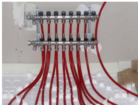
Figure II.3 : Collecteur équipé de vannes de réglages de débit, de débitmètre de contrôle avant raccordement a la chaufferie
