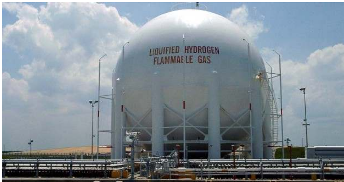
Figure 2.6 : cuve de stockage d'hydrogène
