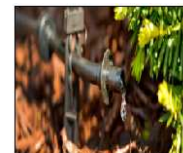
Figure 6.57 : Système irrigation goutte à goutte Source : irrigationcharron.ca
