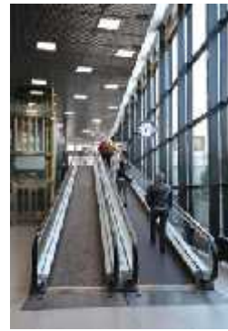
Figure 2.18 : escalier mécanique Source : https://architectes.ch
