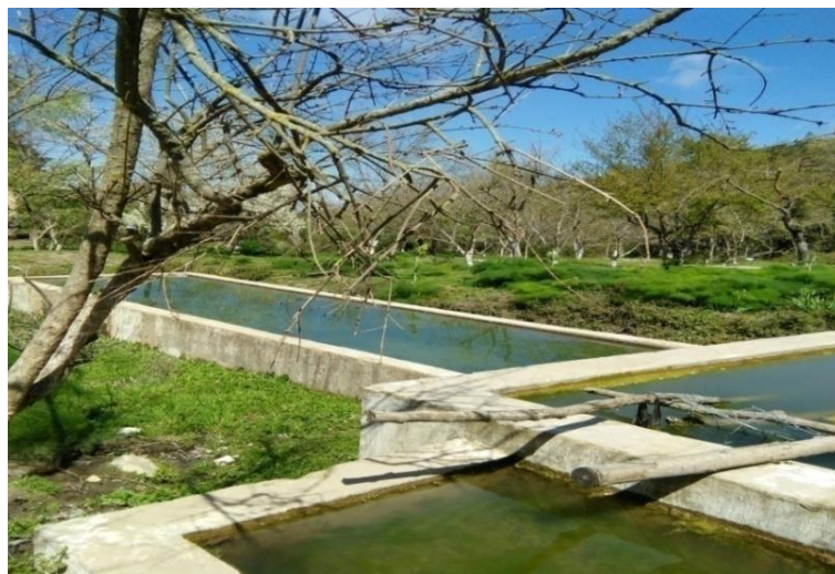
Figure 25 : Point d'accumulation d'eau (Original, 2017).
