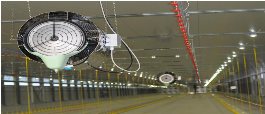
Figure (I-7): Un humidificateur [9]
