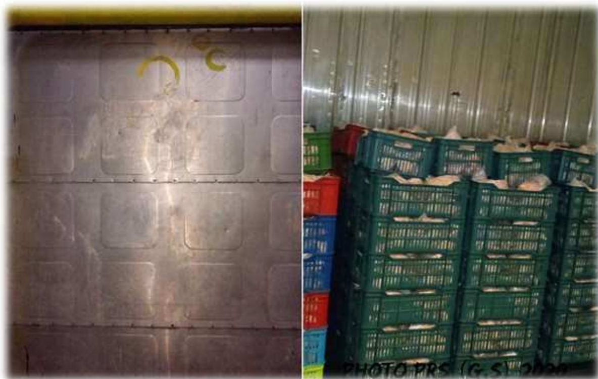
Figure n° 77 : Chambres de réfrigération
