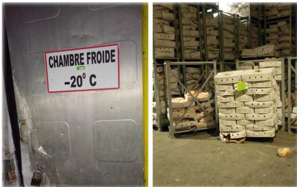
Figure n°82: chambre froide de conservation -20°C
